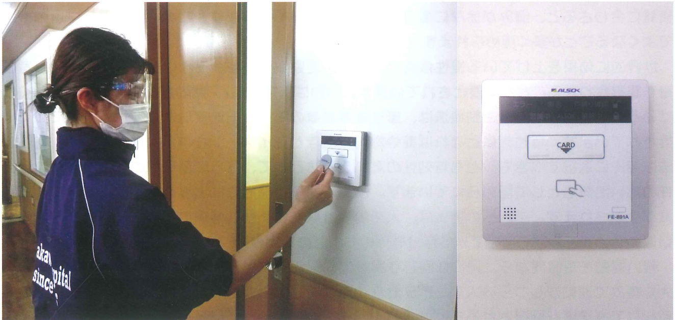
本年3月に新設した電子錠
